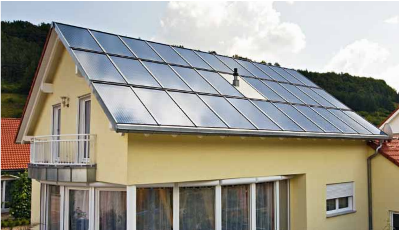
Einfamilienhaus in Bad Mergentheim Dachintegrierte Photovoltaik-Anlage 8,7 kWp zur Stromerzeugung
