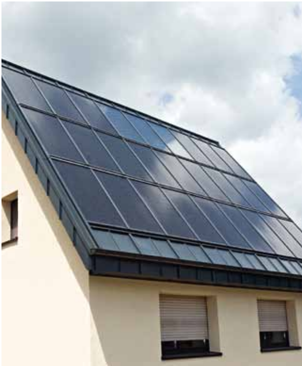
Wohnhaus in Münster Solaranlage 6,3 m 2 zur Trinkwassererwärmung in Kombination mit 6,5 kWp Photovoltaik
