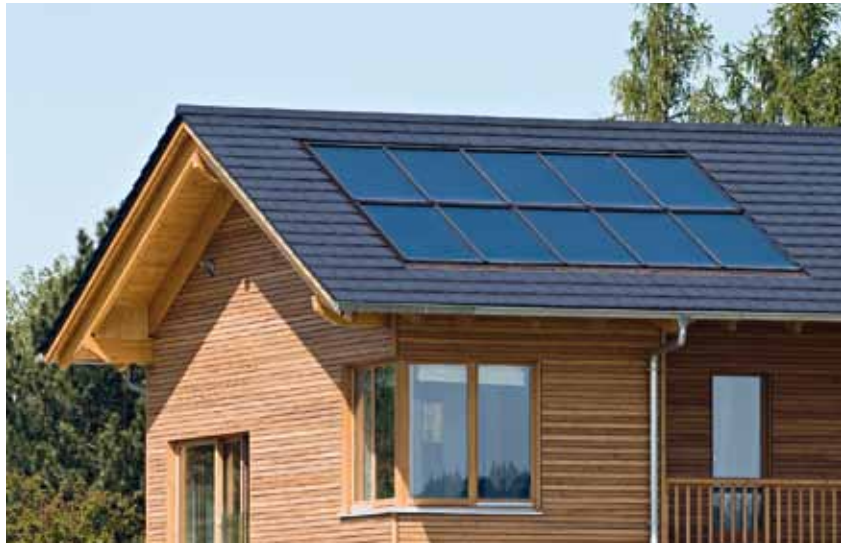
Wohnhaus in Windach Solaranlage 21,2 m 2 zur Trinkwassererwärmung und Heizungsunterstützung
