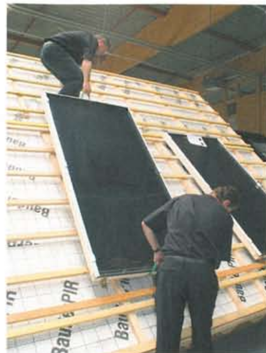
Demonstration einer Solaranlage auf dem Dach im Schulungszentrum Rotocampus.
